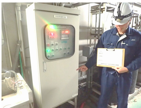
制御盤の確認状況
