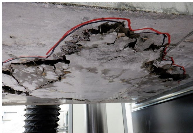
(裏面) 変位状況
