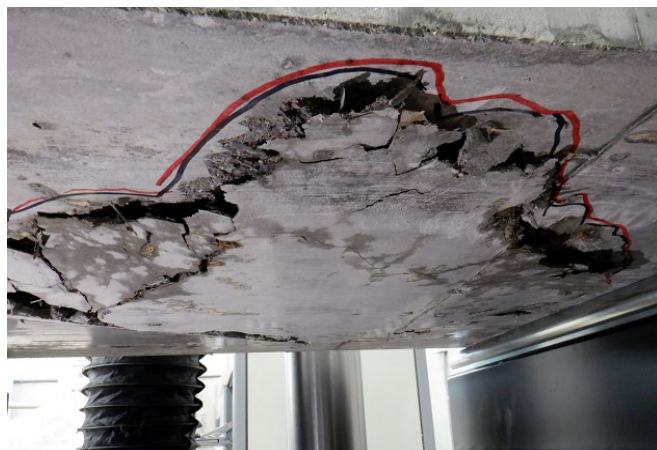
(裏面) 変位状況
