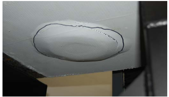
(裏面) 変位状況
