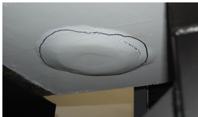
(裏面) 変位状況
