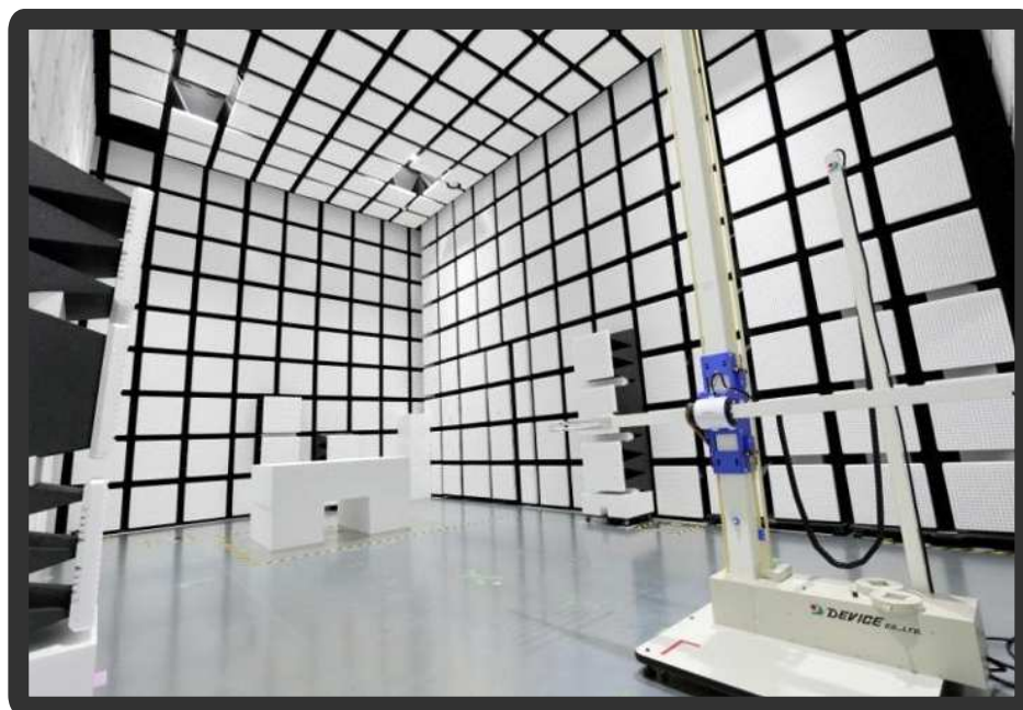
- 3m法電波暗室 -
