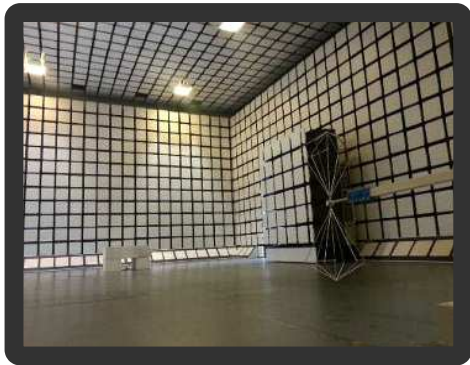
- 10m法電波暗室 -
