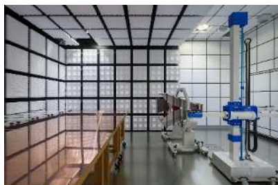
メーカーごとの異なるスペックに対応可能な 車載機器専用電波暗室
